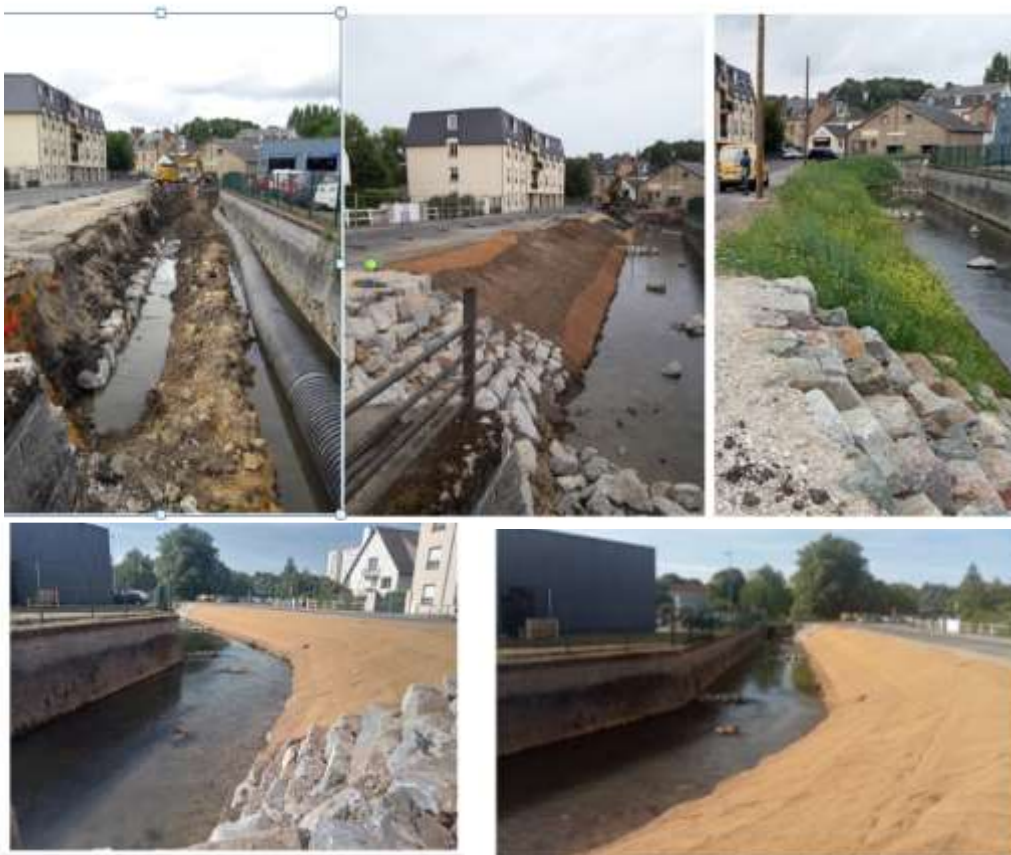
- Tronçon 1 : élargissement du lit du bras nord le long de la rue Apollo 11
